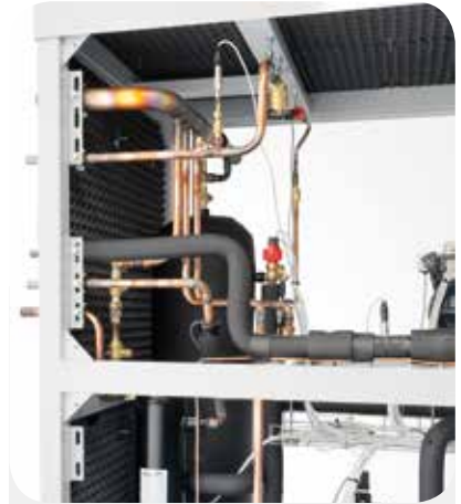
Separatore olio e linea di scarico. Oversize oil separator and discharge line.
