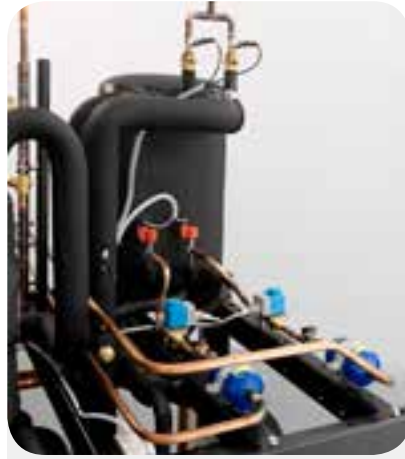
Condensatori a piastre CO 2 e linea liquido/ aspirazione R134a. CO 2 plate heat exchangers and liquid line/ suction R134a.
