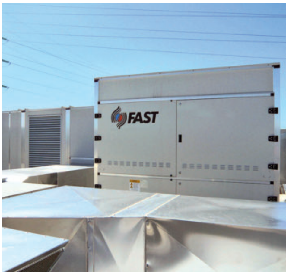
Figura 2 – Roof-top FAST modello MFS. Il roof-top, posizionato sulla copertura del magazzino, è dotato di una batteria ad acqua calda, opportunamente dimensionata per garantire la potenza adeguata quando alimentata con le temperature del circuito dei condensatori
